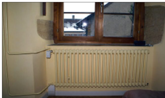
Tous les radiateurs sont équipés d'un servomoteur piloté par l'installation EIB et relié virtuellement aux différents thermostats des zones. La détection des ouvertures de fenêtres permet une mise automatique en mode ECO des zones concernées.
