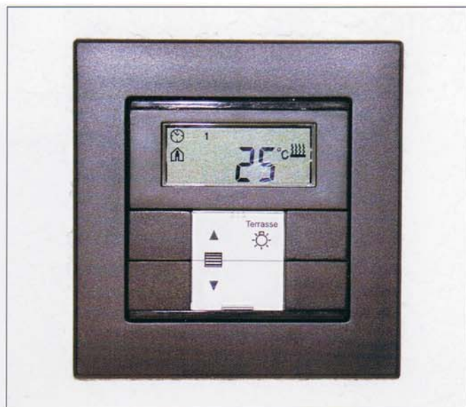
La domotique permet le pilotage de l'ensemble des stores électriques (8 moteurs de stores), un pilotage manuel ou par scénarios, et une position de sécurité et /ou de protection solaire automatique en liaison avec la station météo.
