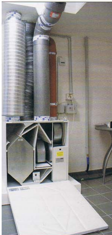
t à fait novateur, le système de ventilation double-flux fait appel à un puits canadien traditionnel enterré à 1,20 m de profondeur pour de la maison.
