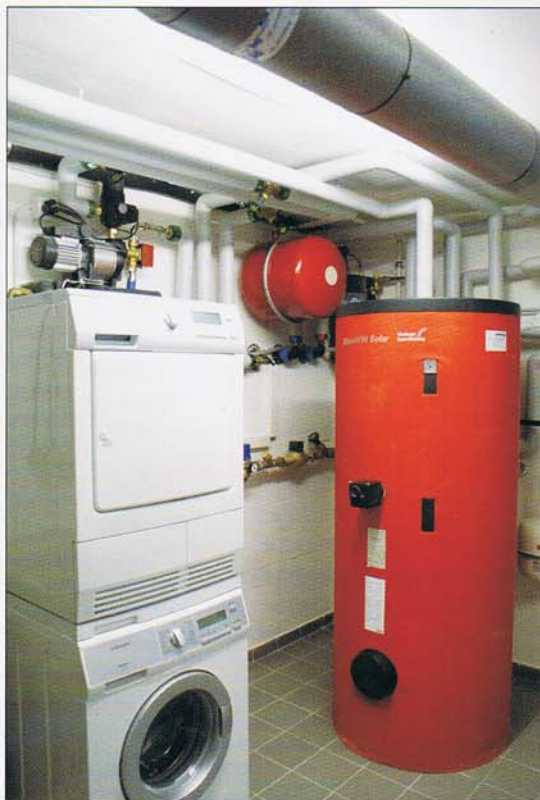
Le local technique, avec son boiler de 450 litres relié aux capteurs solaires et au poêle à pellets.
