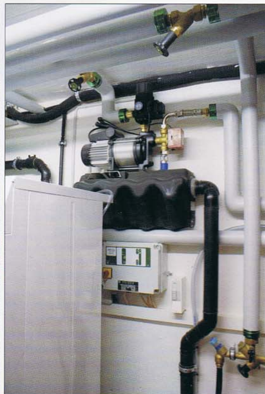
Relié à une citerne enterrée de 7500 litres, le système de distribution de l'eau de pluie pour les sanitaires, la machine à laver et le jardin.
